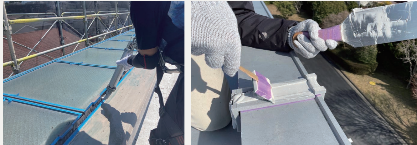
シーリング工事 ※部位や用途によって、充填するシーリング材が異なります。 漏水部シーリング打替補修
