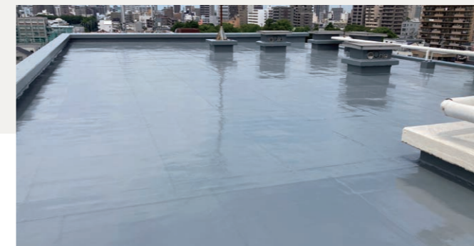
愛知県名古屋市東区マンション 屋上防水工事 ウレタン塗膜防水 650㎡
